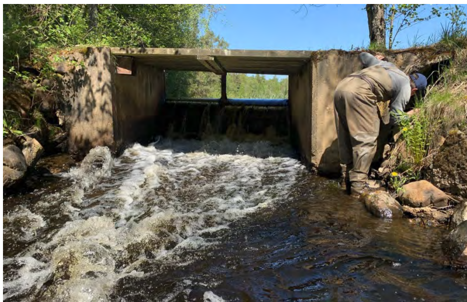
Figur 8. Uppströmsvy mot högra sättutskovet. Erosionsskador förekommer på nedströmssidan av utskovets sidor.
