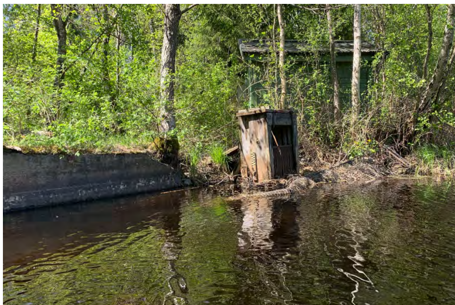
Figur 11. En pegel sitter monterad på intagshusets sida, nedströmsvy.
