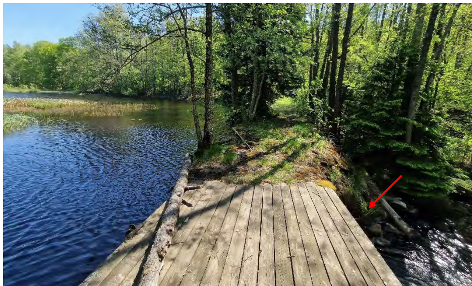
Figur 4. Dammvallens sett från höger sida. Vid röd pil förekommer läckage i dammvallen.
