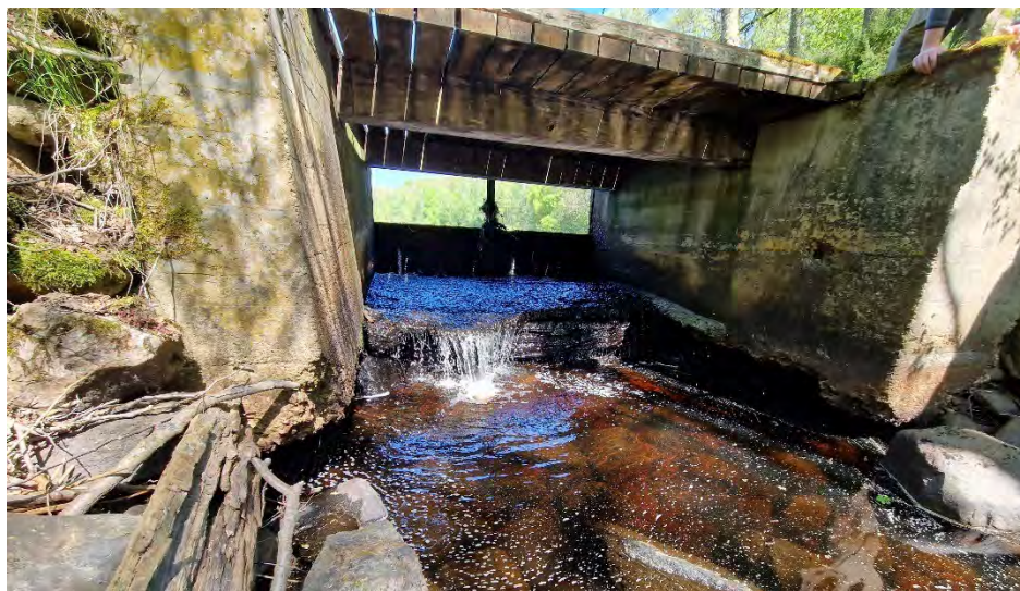
Figur 6. Uppströmsvy mot vänstra sättutskovet. Stora delar av utskovets skibord i betong har försvunnit och vattnet har eroderat in under utskovets sidor.
